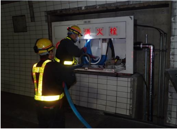
<トンネル非常用設備点検>
